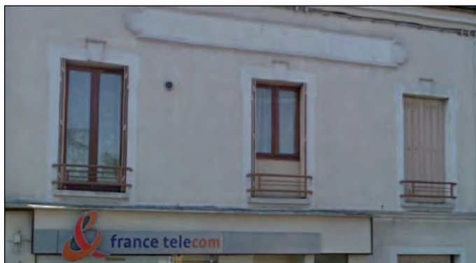
ALTÉRATION DES MENUISERIES D'ORIGINE
