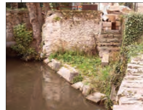
LAVOIR OUVERT ALTÉRÉ (MARGELLE DE RIVE DÉGRADÉE)
