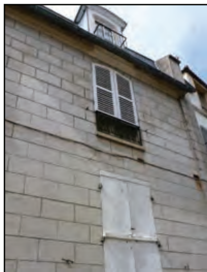
FAUX CALEPINAGE EN ENDUIT
