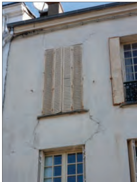
TROP FORTE RIGIDITÉ DES ENDUITS CIMENT
