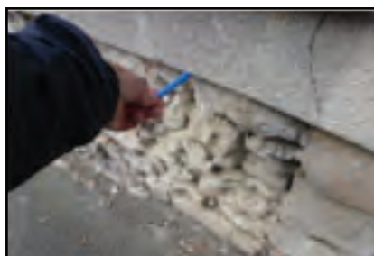
ÉPAISSEUR DE 6 CM CONSTATÉE SUR CETTE FAÇADE
