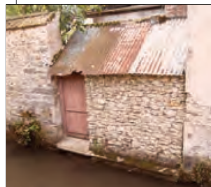
LAVOIR COUVERT ALTÉRÉ (COUVERTURE DISPARUE, OUVERTURE BOUCHÉE)
