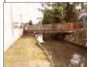
PASSERELLE DU CENTRE CULTUREL (RUPTURE DU PASSAGE)
